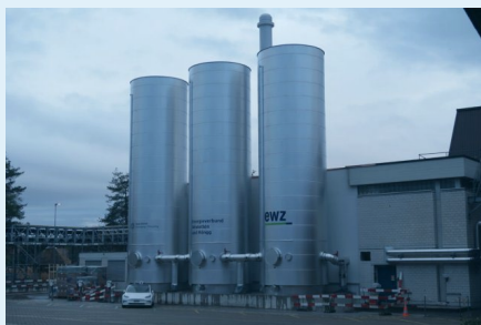
TES at EV Altstetten
